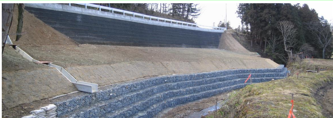
14災1096号旧国道107号線道路災害復旧工事 (この現場では、抑止杭・水抜きポーリング等も含まれておりました。)
