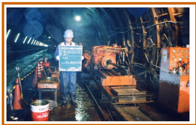
長野県・権兵衛トンネル工事 先進ボーリング 総掘延長 480m
