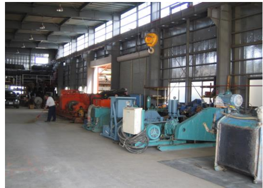
ボーリングポンプ等
