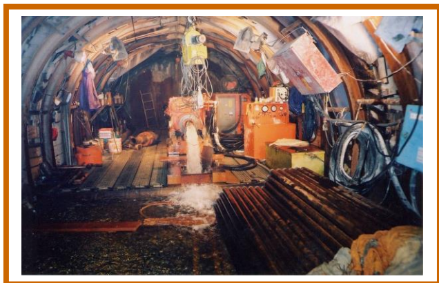
岐阜県・飛騨トンネル避難坑工事 先進ボーリング 総掘延長 500m
