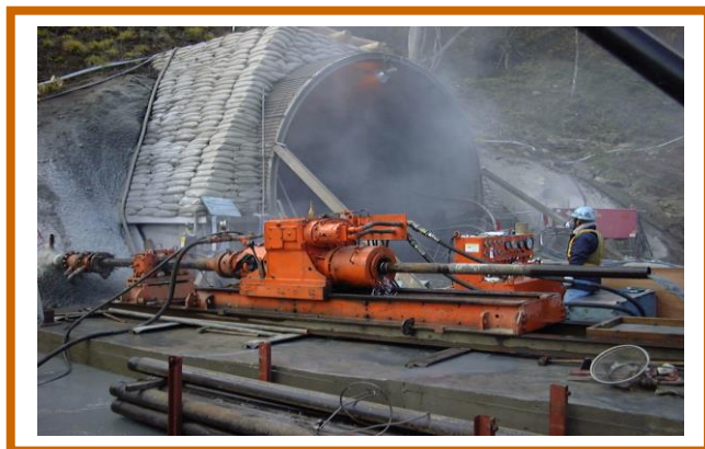
青森県・八甲田トンネル工事 先進ボーリング 総掘延長 333m
